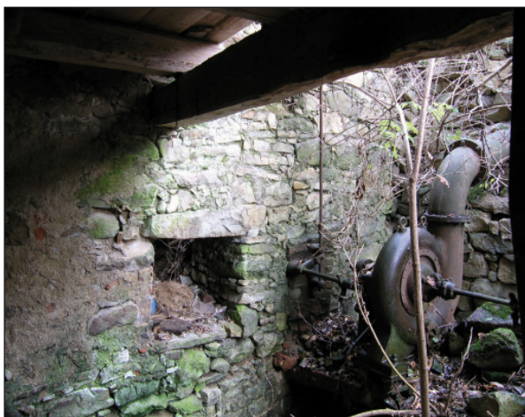
Obr. 22. Radešice čp. 9, vodní mlýn zvaný Jedličkův. Turbína v jižní části lednice, vlevo otvor pro hřídel vodního kola. Foto 2005.
