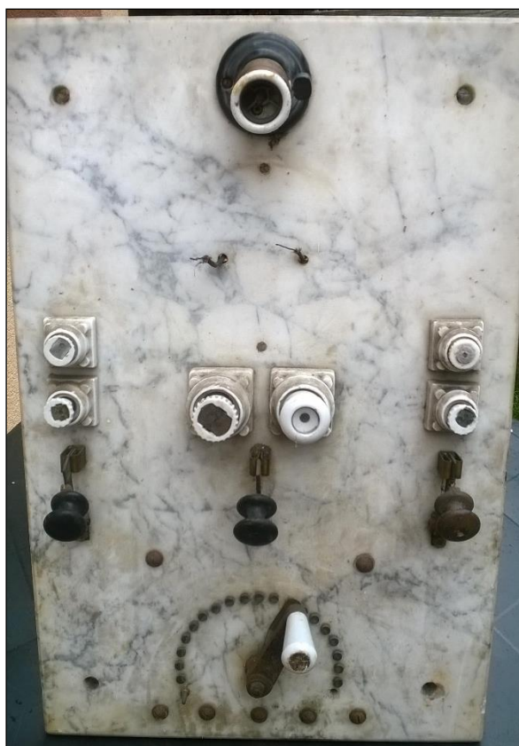
Obr. 21. Rozvodná deska. Foto J. Svatoš, 2016.
