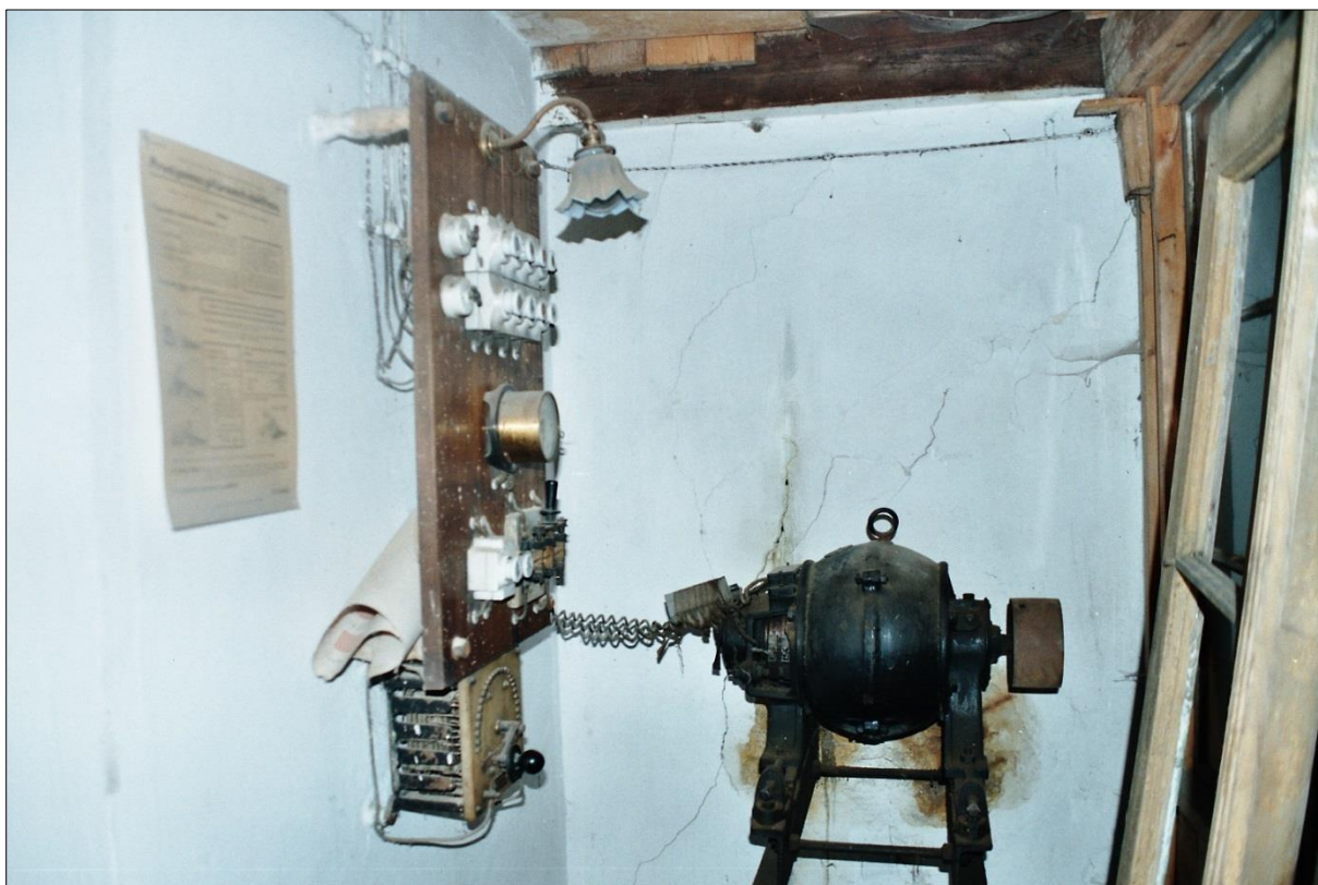
Obr. 23. Rotterův mlýn, Městská Habrová čp. 734 (RK), dynamo s elektrorozvodnou deskou z 1. čtvrtiny 20. stol. Foto D. Veverka 2008.
