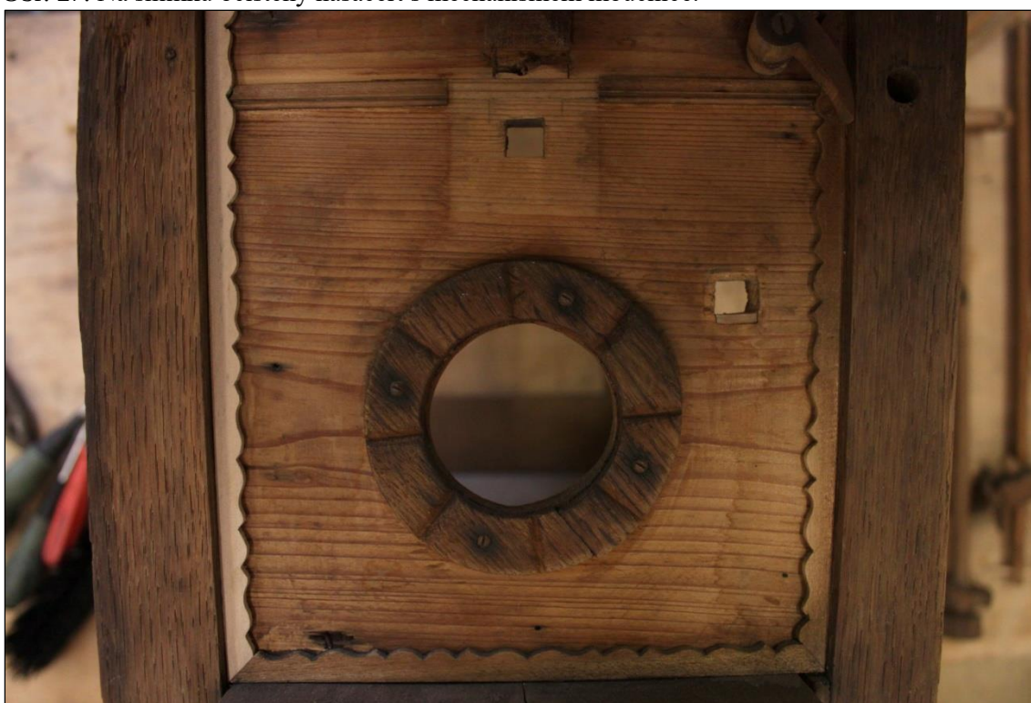
Obr. 28. Na snímku přední čelo moučnice, s doplněnou lištou a opravenou prasklinou.
